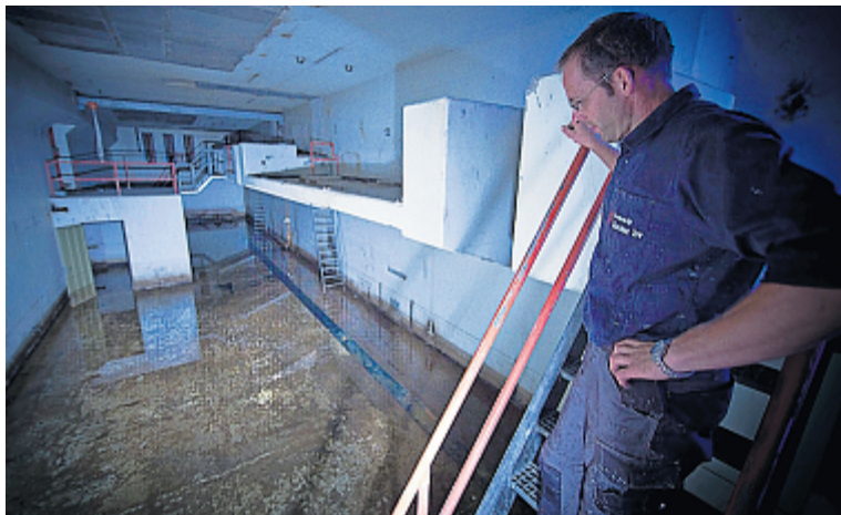
Theo Bergstra van bouwbedrijf Koster in de lekkende kelder. FOTO LC/WIETZE LANDMAN
